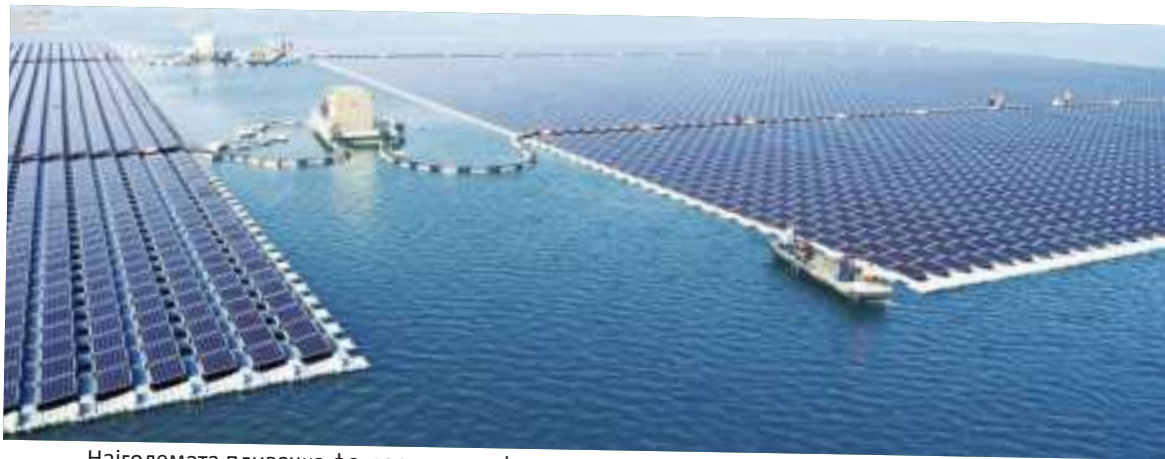
Најголемата пливачка фотоволтаичка фарма изградена во близина на градот Хуајнан во Кина. Инсталирани се 120.000 соларни панели со вкупна моќност од 40 мегавати. Поставена е на површината на езеро настанато со потопување на поранешен рудник за јаглен.
